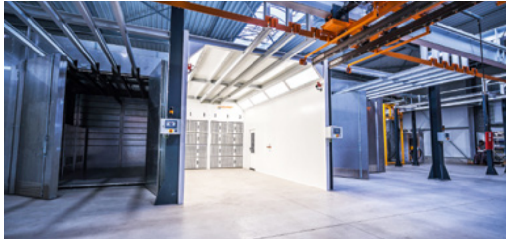
Um die bis zu 500 kg schweren Baugruppen durch die Beschichtungstechnik zu fahren, sind für die jeweiligen Prozessschritte Förderstrecken erstellt. Foto: Durst
