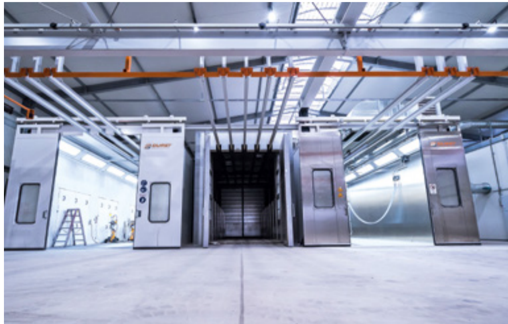
Blick in die neue Lackierhalle. Die Lackiertechnik umfasst eine Strahlkabine, eine Edelstahl-Waschkabine, einen kombinierten Haftwassertrockner und Pulvereinbrennofen sowie eine Großraum-Pulverkabine.
